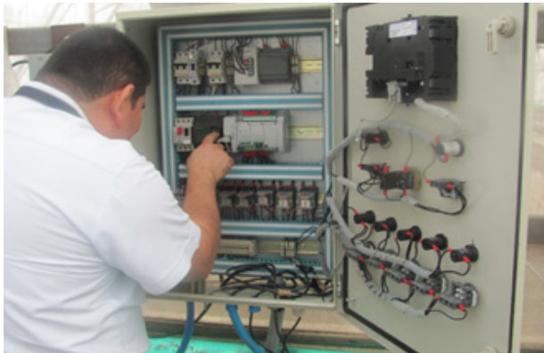
Fig. 2 PLC y sistema para control de riego automatizado del invernadero.
