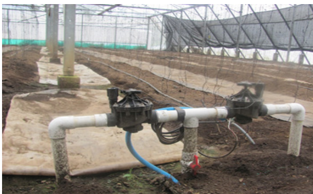
Fig. 3. Electrovalvulas instaladas para cada zona del invernadero.
