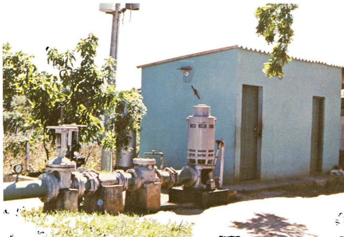
Planta de Bombeo Santa Fe en Zacatecoluca, Departamento de La Paz.
