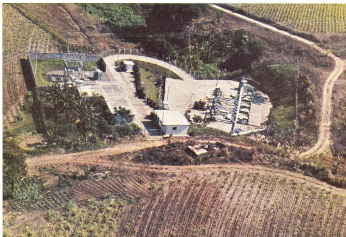
Estación de Bombeo San Lorenzo sector San Juan Opico, Departamento de La Libertad.
