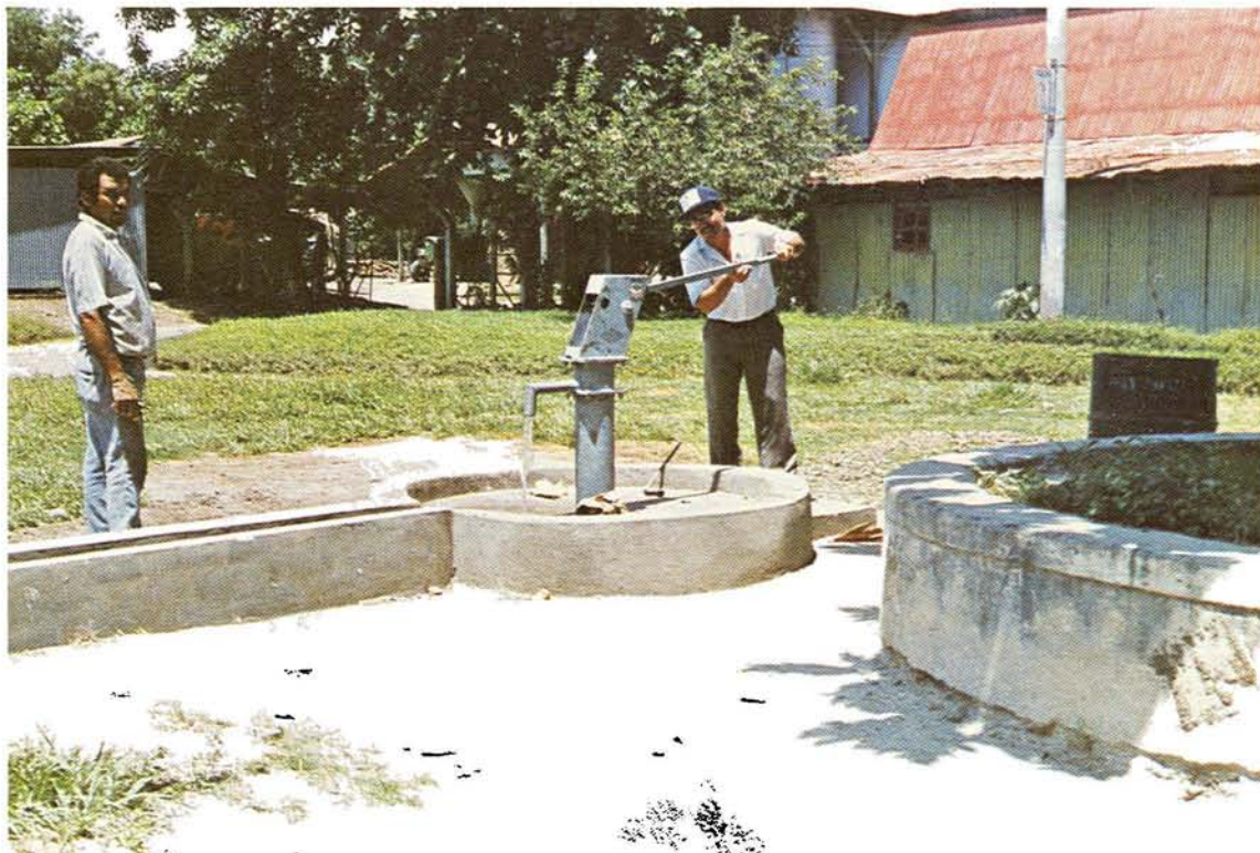
Programa de instalación de bombas manuales para atender parcialmente al sector rural.
