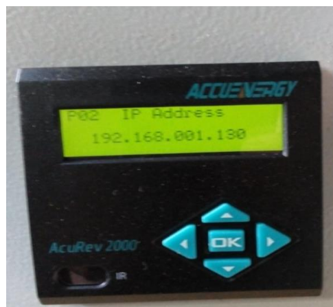
Pantalla del medidor ACCUENERGY 2000
