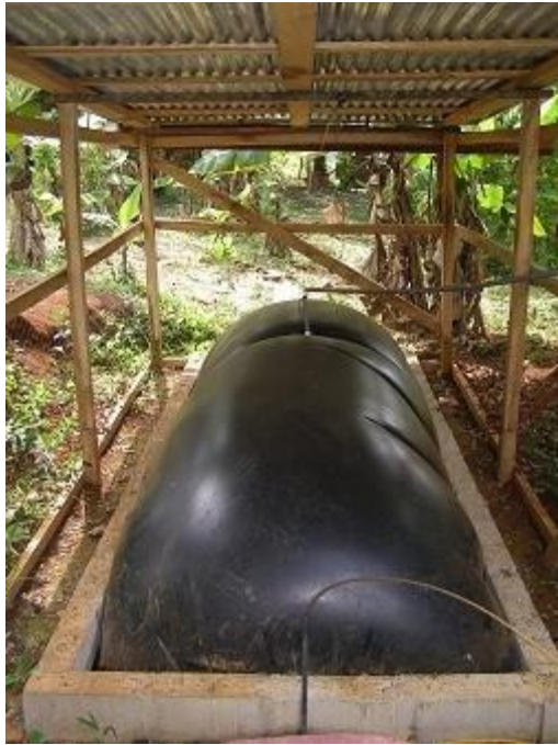
Figura # 5, Biodigestor de estructura flexible, bioreactorcrc.wordpress.com
