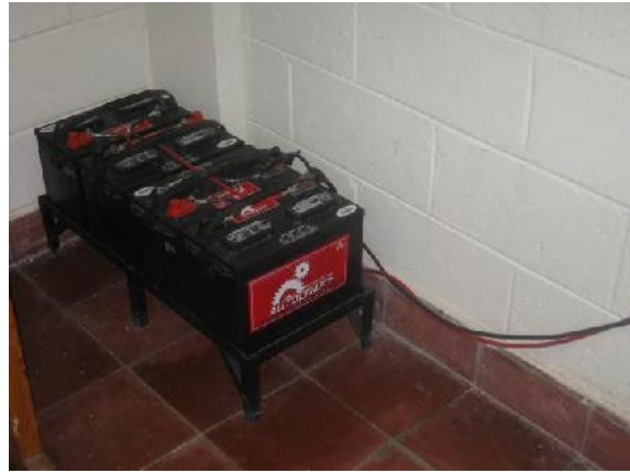
Fig. 21. Banco de baterías
