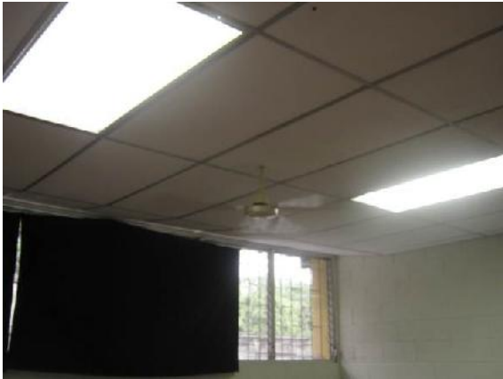
Fig. 24. Sistema de iluminación y ventilación funcionando con energía renovable.
