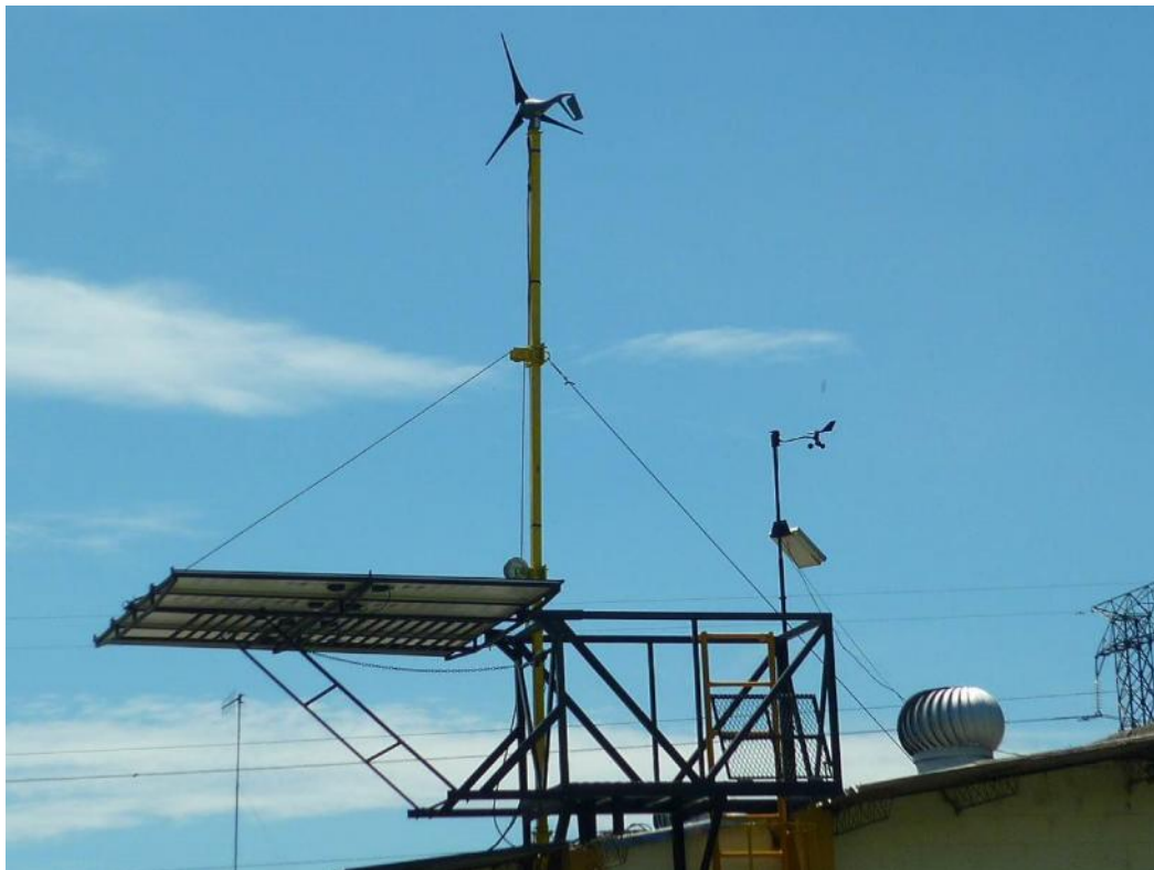
Fig. 26. Vista de los paneles fotovoltaicos y aerogenerador
