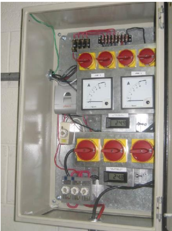
Fig. 22. Panel de Control
