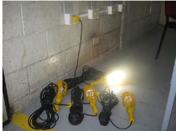
Fig. 25. Lámparas para taller de mecánica automotriz, funcionando con energía renovable.
