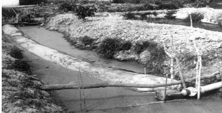
Figura # 6, Biodigestor de estructura flexible.
