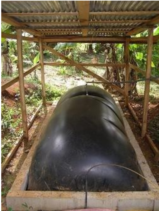
Figura # 5, Biodigestor de estructura flexible, bioreactorcrc.wordpress.com
