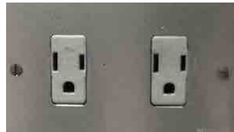
Imagen N° 1: Fotografía de tomacorriente de la Escuela de Diseño Aulas 1,2 y 3.
