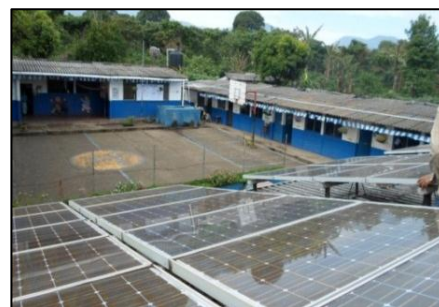
Sistema Fotovoltaico del C.E.
