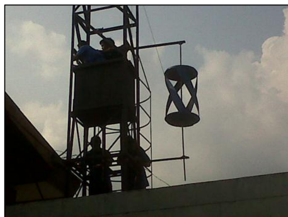
Rotor instalado en estructura del Taller de Ingeniería Mecánica de ITCA.FEPADE Sede Central.
