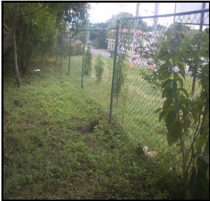
Figura 69. Estado actual del muro.
