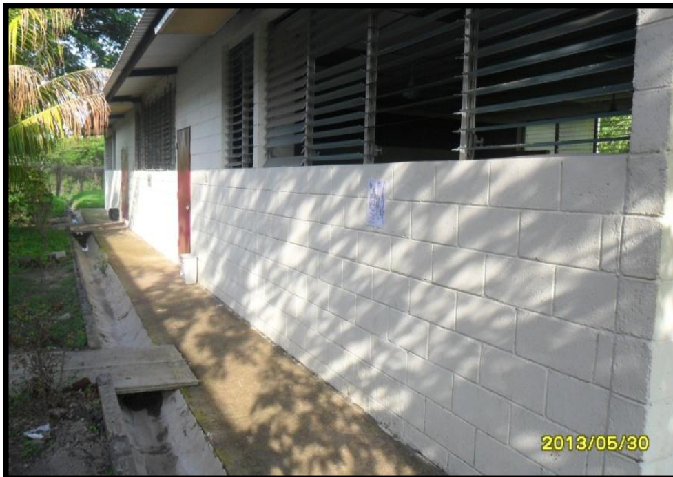
Figura 51. Las aulas 7 y 9, y de mantenimiento fueron construidas recientemente y fueron construidas con bloque de concreto.
