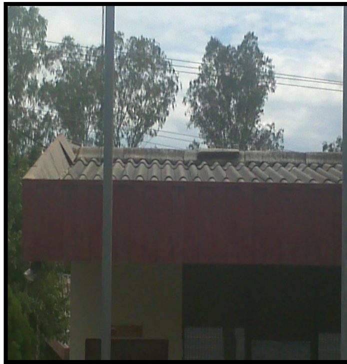
Figura 67. Estado actual de los techos
