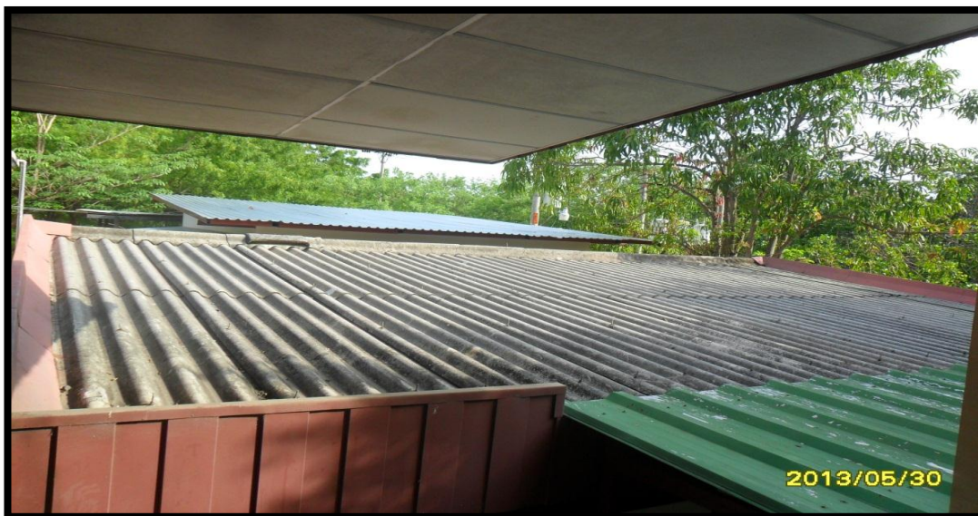
Figura 53. Servicios sanitarios con Lámina de Asbesto Cemento.
