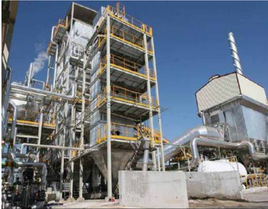
Fig. 3.15. Caldera de combustión de biomasa (Fuente: Fuente: Documento "Plantas de Biomasa", autor: Natalia Fernández Castaño, 2010, http://www.renovetec.com/ , www.limpiezastecnicasindustriales.com )
