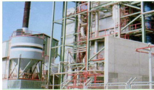
Fig. 3.20. Ejemplos de Plantas de Combustión de Biomasa (2.3, 8.7 y 12 MWe).
