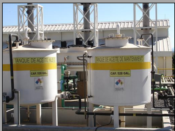
TANQUES DE ACEITE
