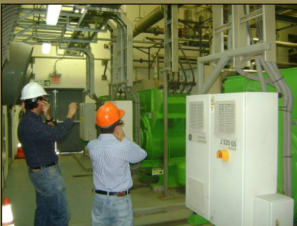
CASA DE MÁQUINAS
