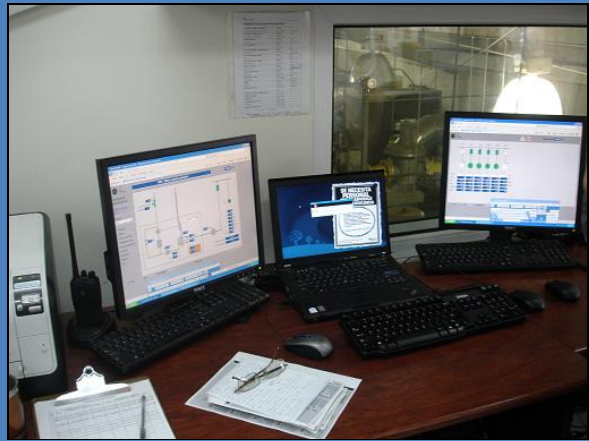
SALA DE CONTROL
