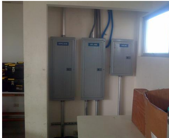
Fig. 23 Fotografía real de donde están ubicados los tableros de las protecciones.
