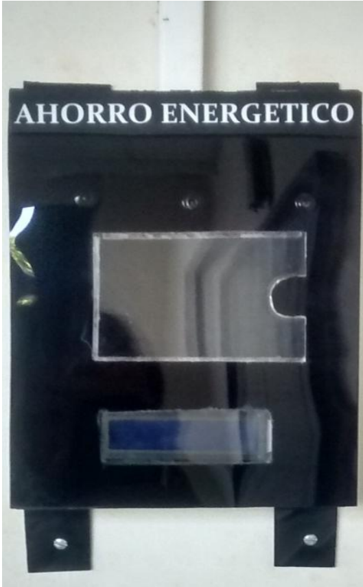
Lector RFID Instalado Dentro del aula
