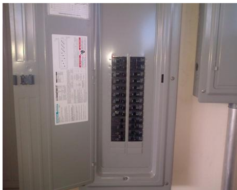
Fig. 21. Fotografía del tablero central que controla las luminarias, tomacorrientes y aires acondicionados.
