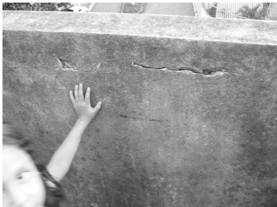
Foto 25. Detalle de las grietas en las paredes. (Fuente: fotografía tomada por la autora.)
