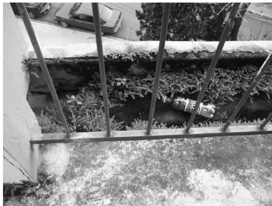
Foto 26. Vegetación espontánea dentro de los canales de drenaje de la azotea. (Fuente: fotografía tomada por la autora.)
