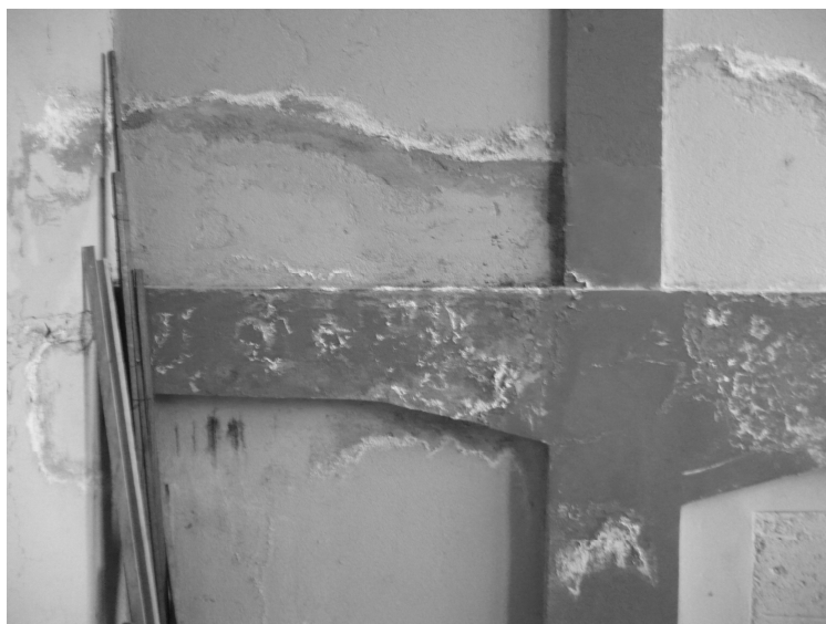
Foto 75. Manchas de humedad en las paredes del cubo de escaleras de uno de los edificios del Centro Urbano Lourdes, San Salvador. (Fuente: fotografía tomada por la autora.)
