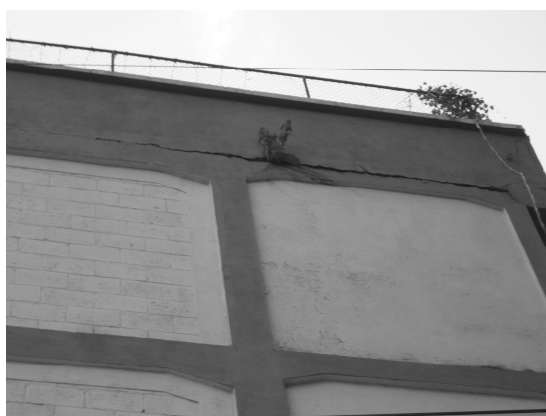
Foto 24. Estado actual del edificio. Nótese la grieta en el área en que la pared se una con la losa.
