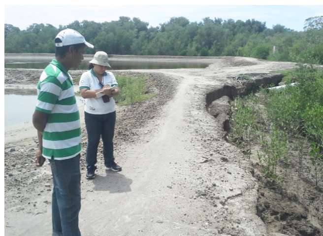
Evaluación del deterioro de las bordas perimetrales de los estanques de la Cooperativa Senderos de Paz. Docente y Jefe de Campo de la Cooperativa.
