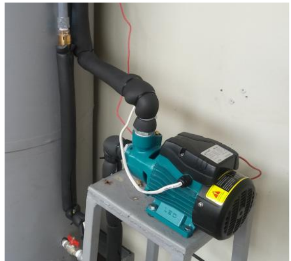
Bomba para recirculación del agua
