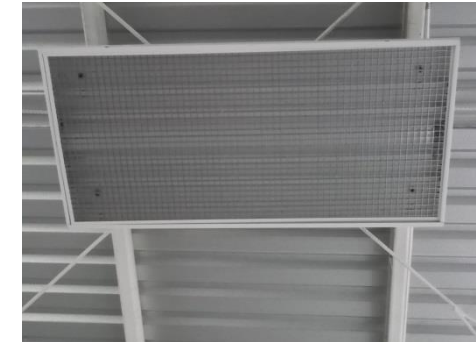
LUMINARIAS EN SALIDA DE EMERGENCIAS
