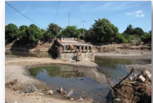
Ilustración 205 DESTRUCCION DE PUENTE MELARA
