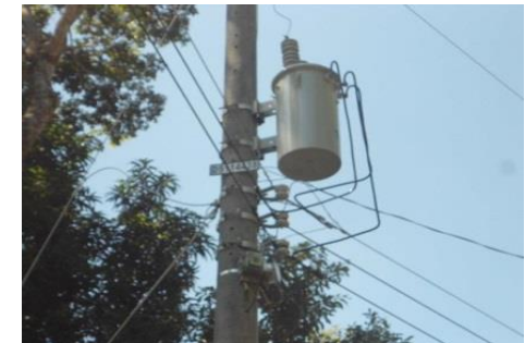
Ilustración 99 TRANSFORMADOR DE ENERGÍA ELÉCTRICA
