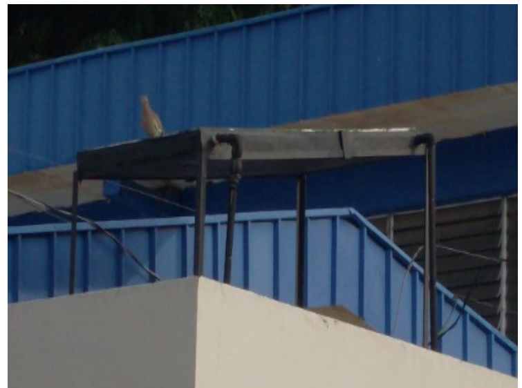
Colector Solar instalado en Laboratorio de Ingeniería Eléctrica
