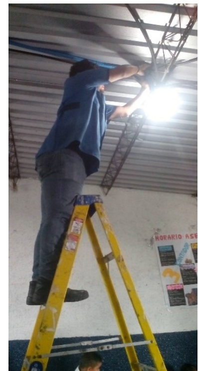
Estudiantes evaluando las condiciones de la infraestructura eléctrica del centro educativo, bajo la supervisión de un docente especialista.
