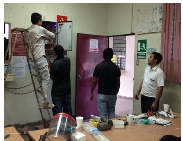
Instalación del sistema en C. R. San Miguel.
