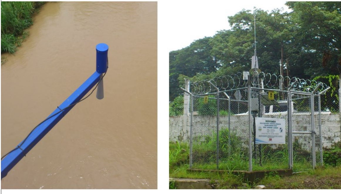
Foto 2 Estación SAT Centralizada aérea y Fuente de comunicación y alimentación eléctrica
