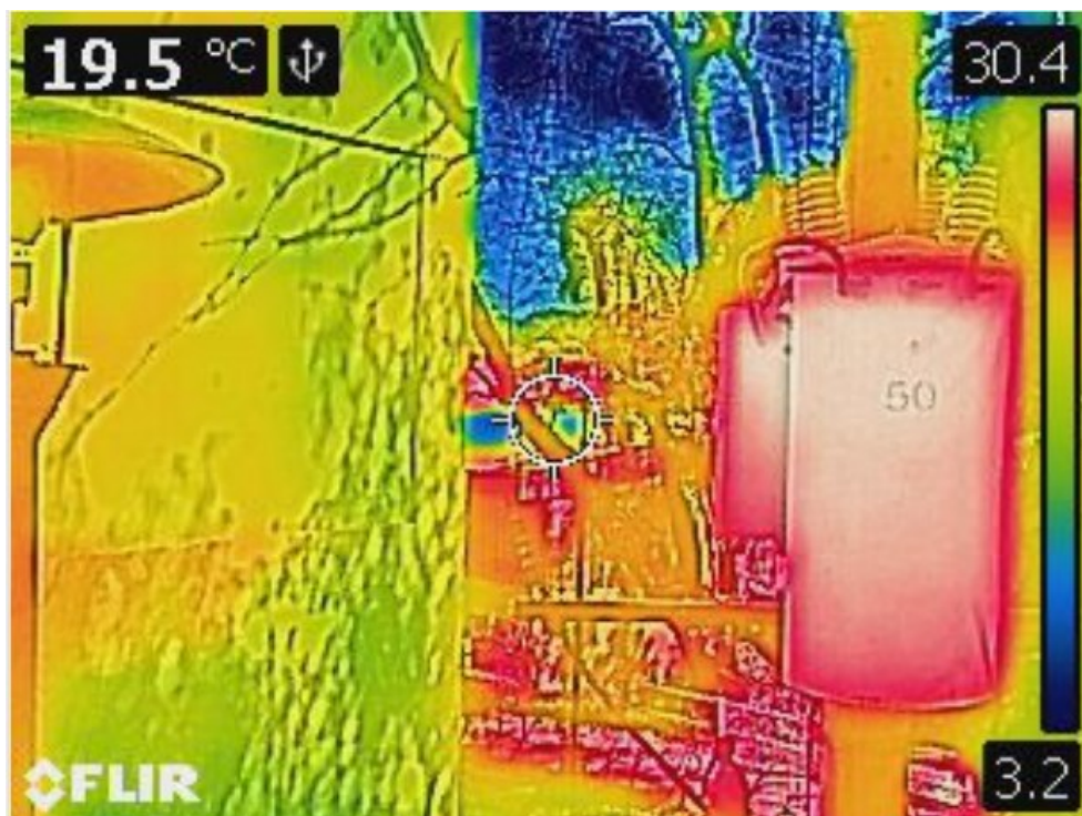
Fig. 42. Termogramas de locación 4
