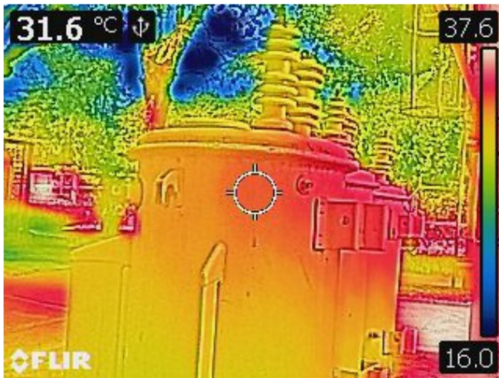
Fig. 41. Termogramas de locación 3
