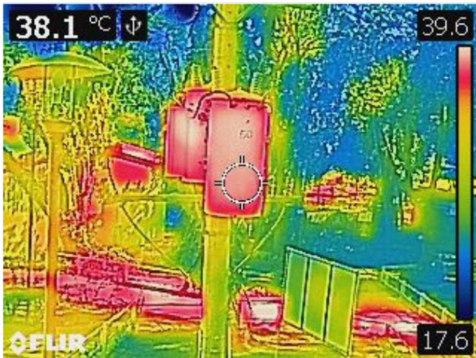
Fig. 43. Termogramas de locación 4
