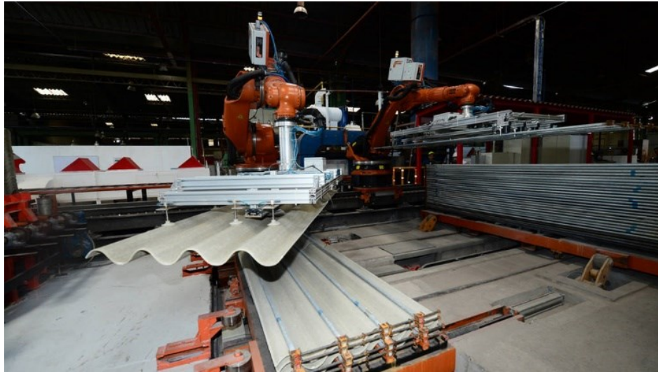
Ilustración 1: Robot industrial instalado en Industria de fibrocemento.
