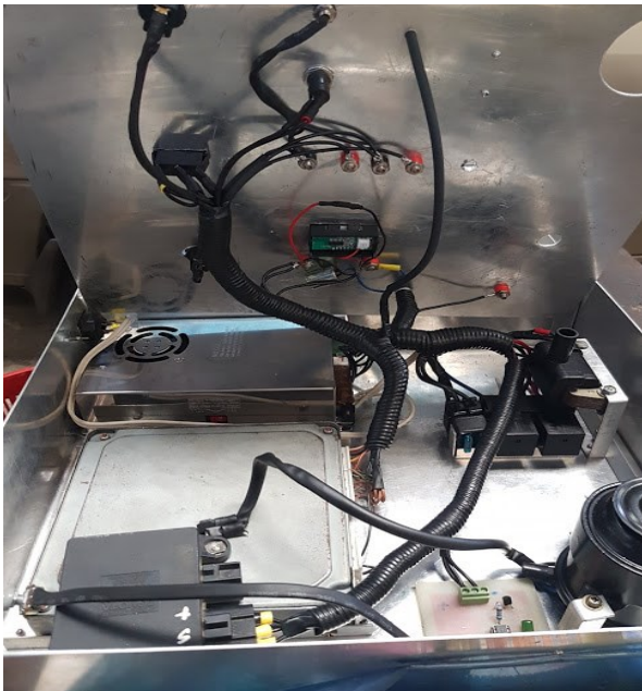
Aislamiento de cable eléctrico de componentes.
