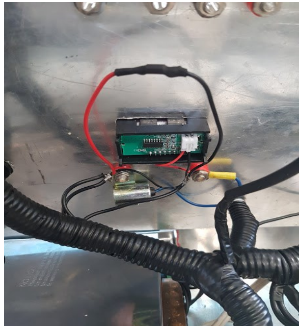
Protección del display de voltaje.
