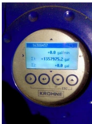
Imagen 1: Flujómetro en refinería
