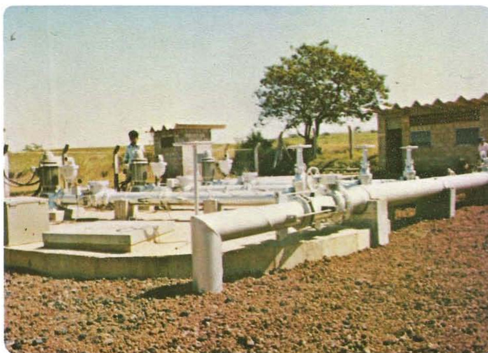
Planta de bombeo La Isla.
