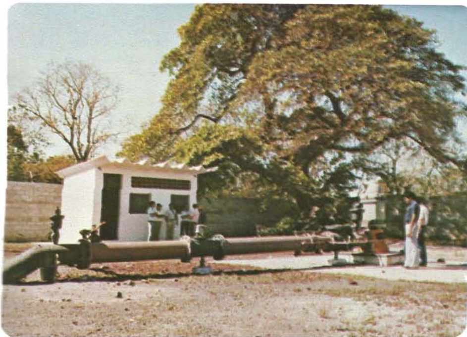
POZO N° 3, OPICO, Aspecto de las instalaciones internas.
