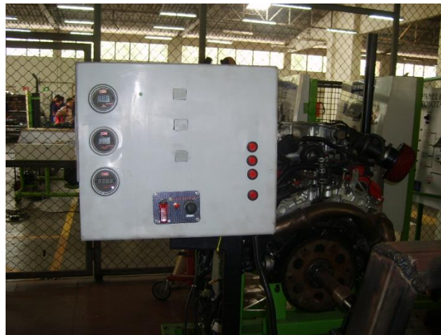
Fig.14 Tablero de control instalado en el banco de prueba
