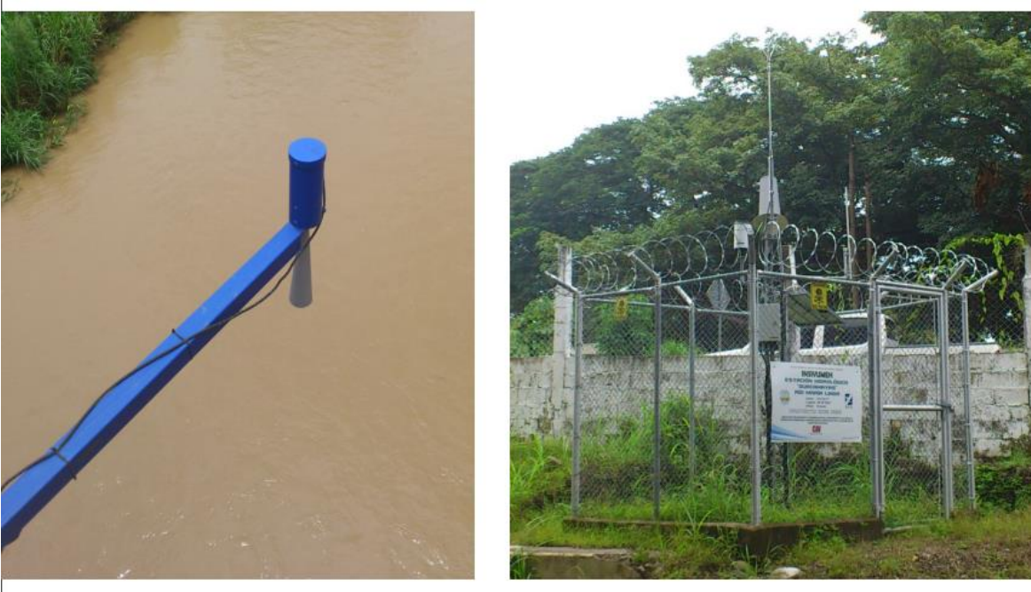
Fig. 7 Estación SAT Centralizada aérea y Fuente de comunicación y alimentación eléctrica
