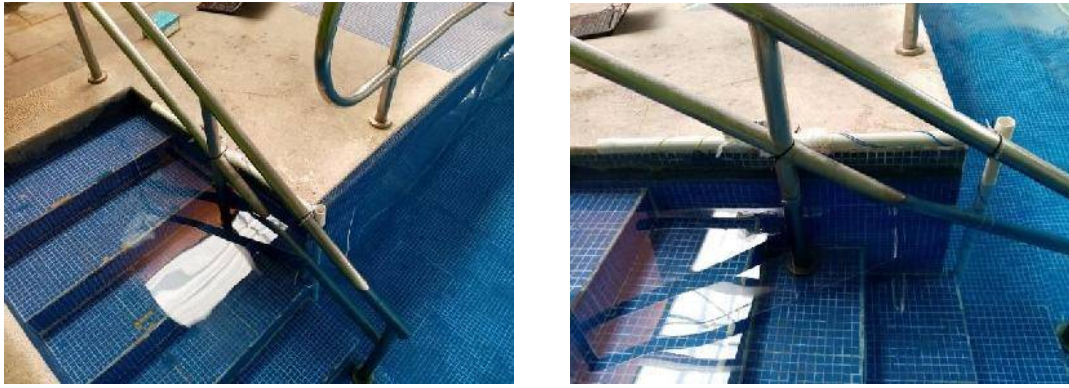
Figura 49. Dispositivo instalado para medición de temperatura dentro de piscina.
