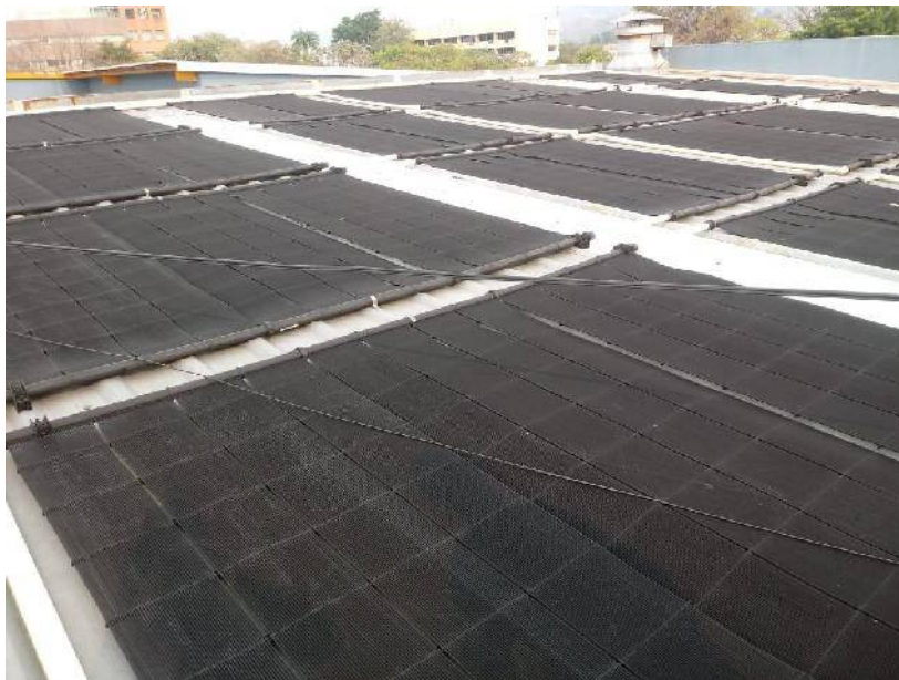
Figura 44. Sistema calentador solar Heliocol sobre cubierta de techo en área de piscina para hidroterapias.
