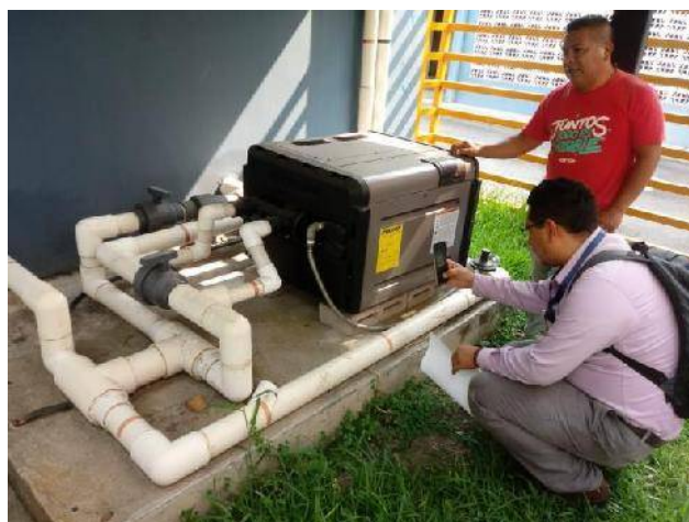
Figura 45. Inspección de calentador de agua a base de gas para piscina para hidroterapias, con apoyo de técnico Geovanny Mélenlez. Fuente: fotografía propia, 2019.
