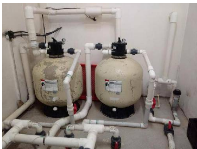
Figura 46. Filtros para agua en área de máquinas de piscina para hidroterapias. Fuente: fotografía propia, 2019.
