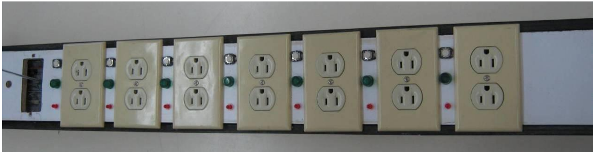
Fig. 17. Módulo de conexión / desconexión de cargas
