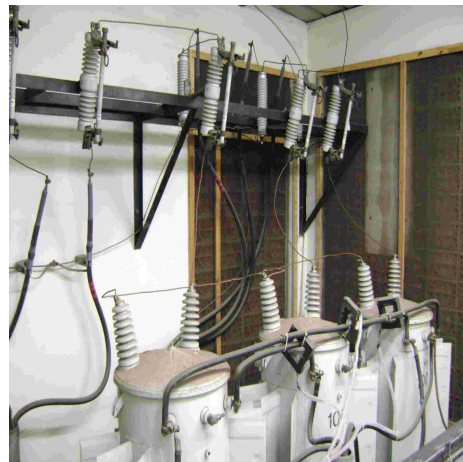
Fig. 1. Banco de transformadores en la subestación a monitorear.
