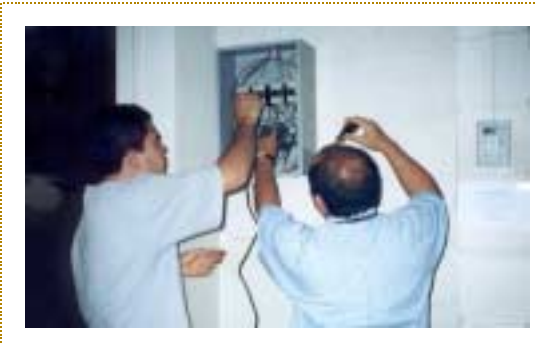
Instalación del Sistema Automatizado en el centro de cómputo del Centro Regional Santa Ana.
