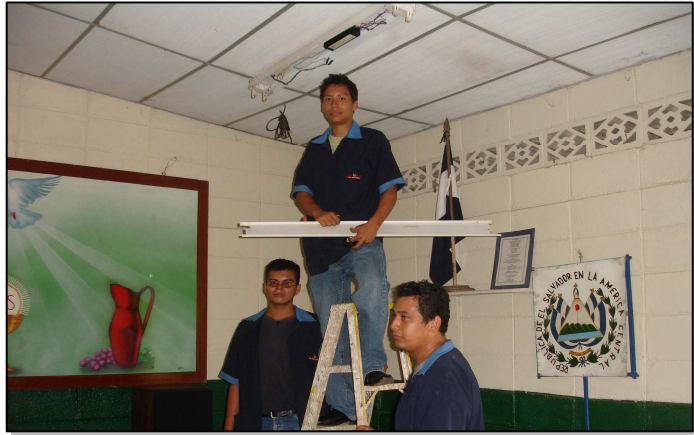
Alumnos en reparación del sistema eléctrico del Centro Escolar Nuestra Señora de la Paz.
