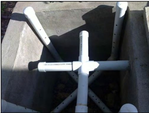
FIGURA No 40: Conexión tubería de Biofiltro
