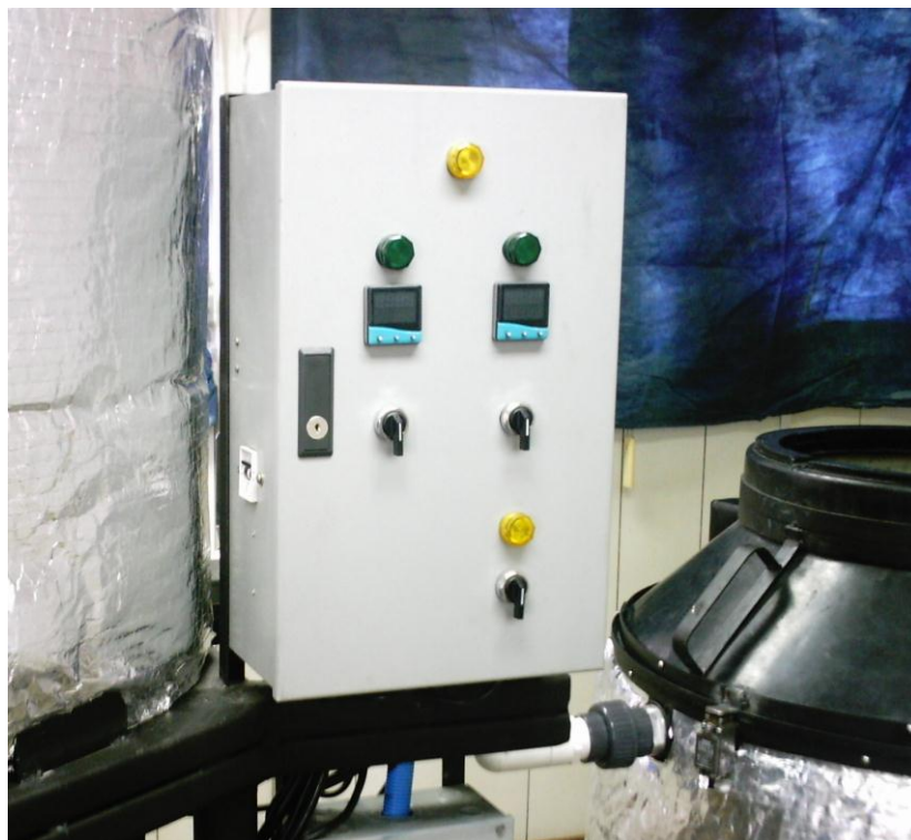
Fig.15 Tablero de control.
