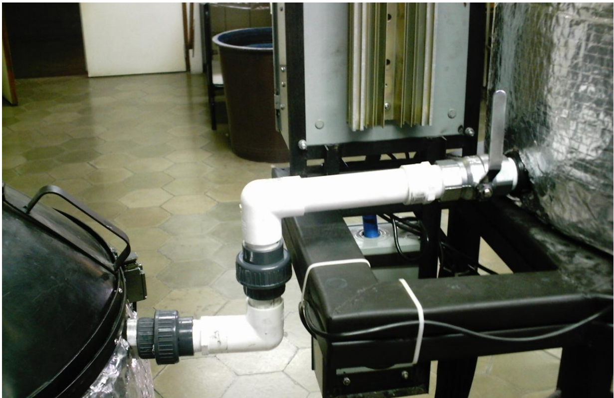
Fig. 12 Transferencia de fluidos del Tanque 1 al Tanque 2.
